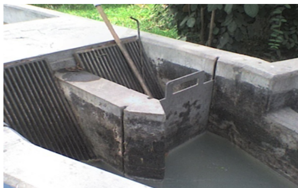
Figura 25: Rejas de 15 mm de separación entre barras.
