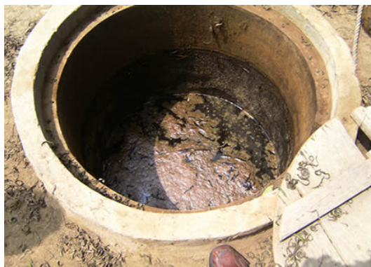
Figura 22: Orificio de extracción del biol del biodigestor de Casa Blanca.
