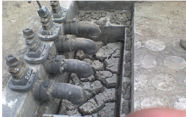
Figura 30: Tuberías empleadas para extraer lodo de cuatro alturas diferentes.
